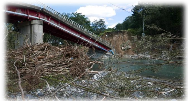
明星橋の落橋の状況を上流右岸から望む（提供：渡邊康玄教授）
