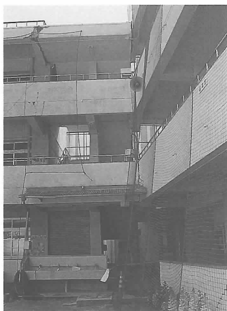
写真 3. 呉市立辰川小学校、階段室 エキスパンションの被害
