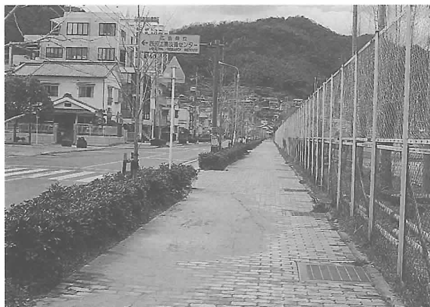
写真 1. 呉高専南側の道路の液状化跡
