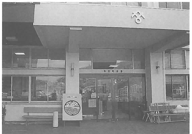
写真24. 沖美町役場玄関、ガラスの破損
