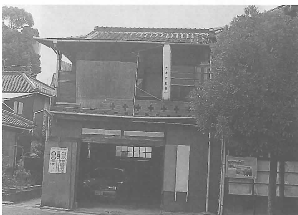
写真10. 呉市本町、わずかな傾き、 2階ベランダのレンガの落下
