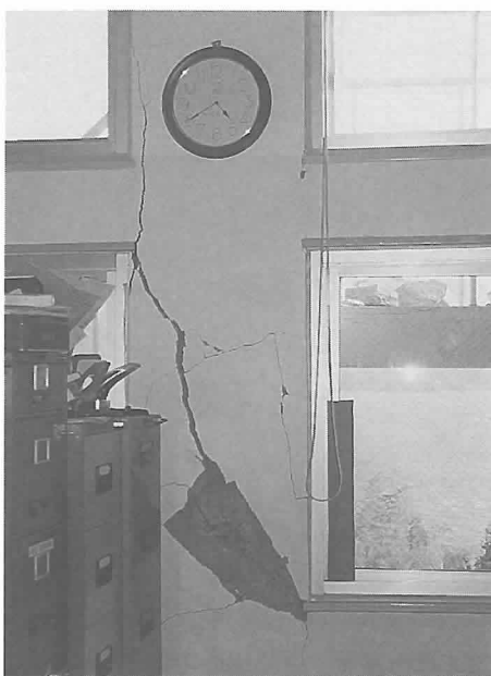
写真23. 沖美町役場、1階柱の剪断破壊
