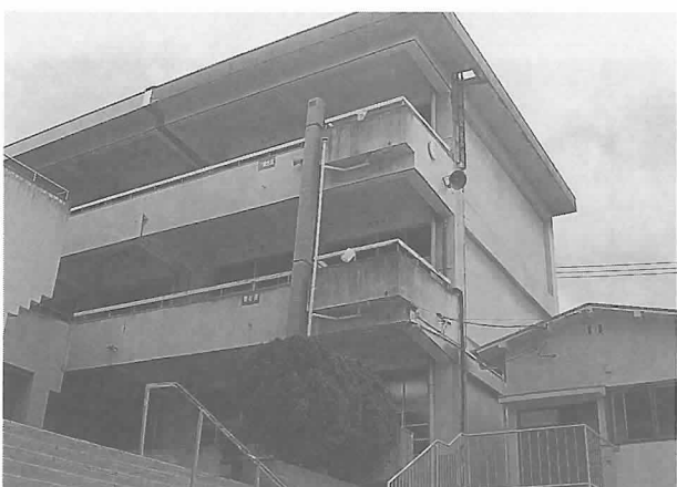
写真11. 呉市立和庄小学校 エキスパンションジョイント部の被害
