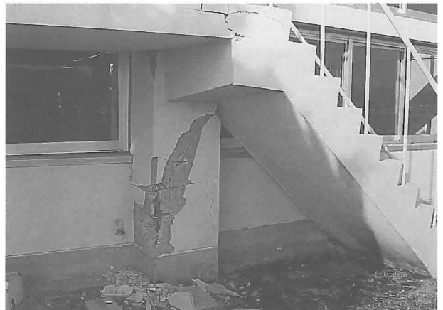
写真22. 沖美町役場、1階中柱の剪断破壊
