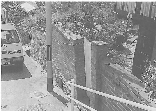
写真7. 呉市江原町のレンガ塀の被害
