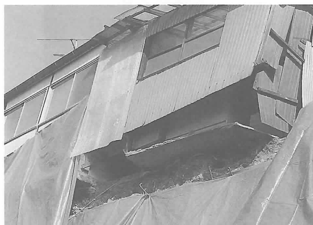
写真18. 呉市宮原、道路脇の宅地がけ崩れ（詳細）
