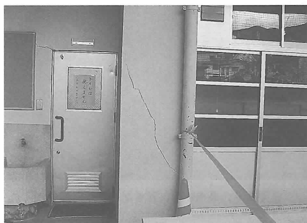
写真 4. 呉市立辰川小学校、南北校舎の柱被害 トイレの停止は屋上水槽の被害による
