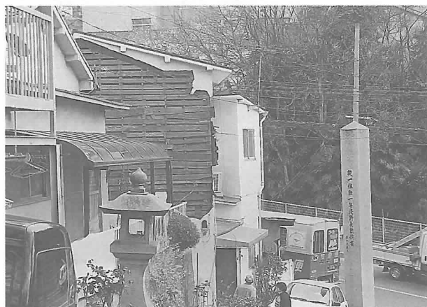
写真16. 呉市清水、民家外壁の剝離
