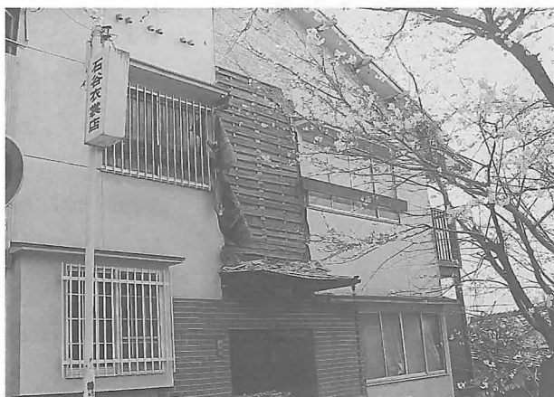
写真15. 呉市清水、民家外壁の剝離
