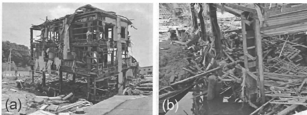
写真 4.5.1 建物 B : (a) 洗堀による基礎の沈下、(b) 沈下した基礎、基礎杭の跡.
