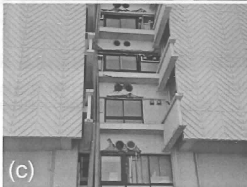
写真 3.2.2 大学校舎 B: (a) 連層壁構造と境界梁、(b) ペントハウスの損傷を含めた外観、(c) 破壊した境界梁。
