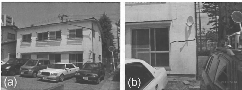
写真 3.1.9 二階建て木造共同住宅：(a) 外観、(b) 漆喰のひび割れと残留変形。
