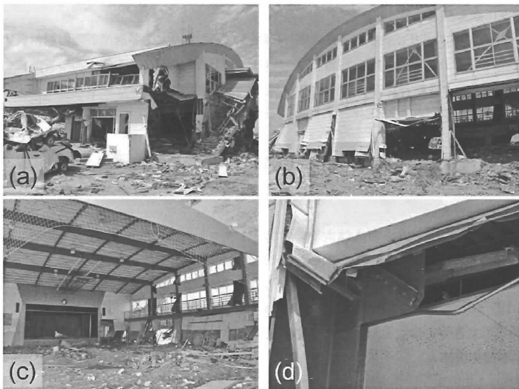
写真 4.1.2 小学校体育館 A : (a) 外観、(b) 外壁の損傷、(c) 堆積物が散乱する室内、(d) 端部の欠損断面で破断した筋違。
