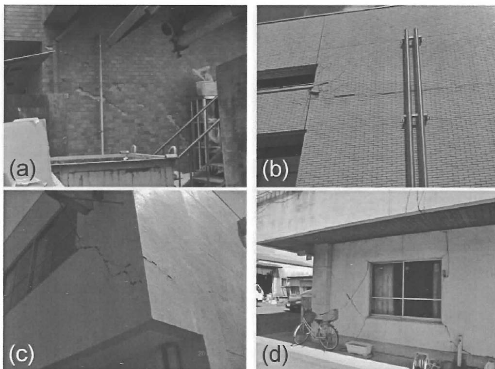
写真 3.1.2 RC 造建築物の外壁損傷：(a) 二階建て研究施設、(b) 三階建て店舗、(c) 二階建て店舗、(d) 二階建て事務所。
