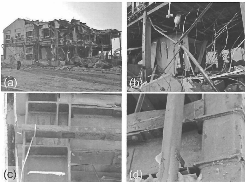
写真 4.2.2 工場 A : (a) 外観、(b) 破壊された X 形筋違、(c) 柱パネルの降伏、(d) 増設部分の梁の曲げ降伏。
