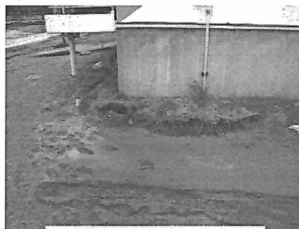
周囲地盤の沈下に伴う段差
