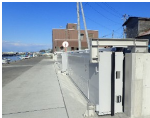
写真 10 高潮対策施設の整備状況 (提供：国土交通省北海道開発局)
