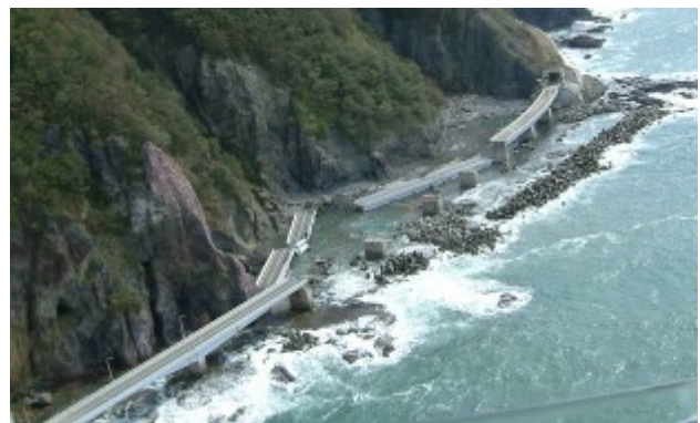
写真-1 大森大橋の落橋状況（本間ら 5) より）
