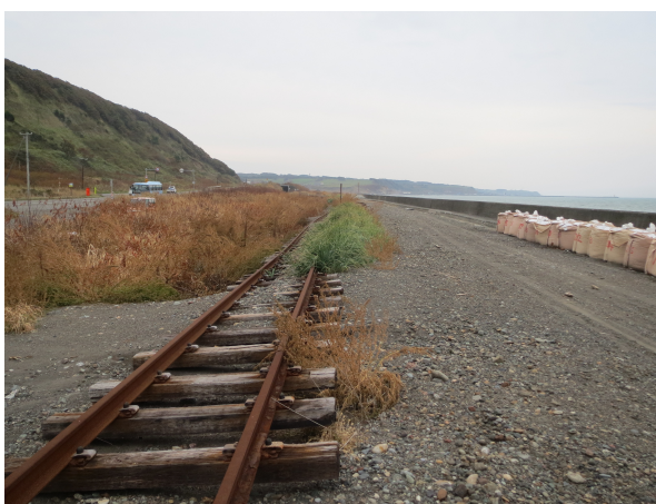
写真-4 JR 日高線の線路被害
